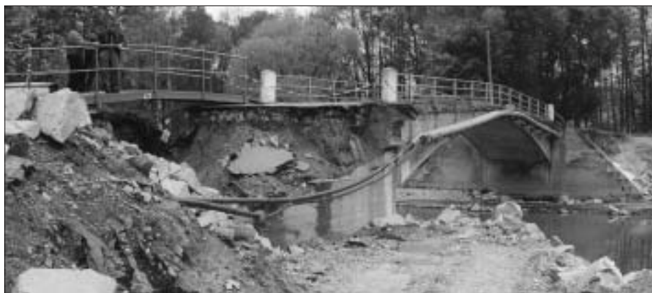
Oprava zničeného mostu v Plavě si podle odhadu vyžádá nejméně 16 mil. Kč
