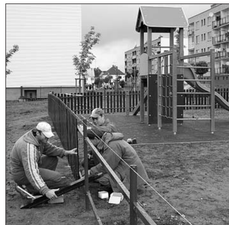
Zaměstnanci stavební firmy dokončují oplocení dětského hřiště za bytovým domem Antonína Slavíčka 50.
